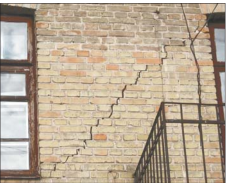
Тріщина в стіні вже сягає 7 сантиметрів
